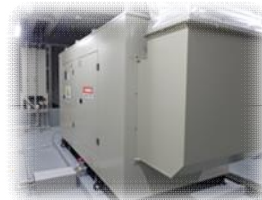
自家発電設備
