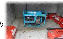
自家発電装置
