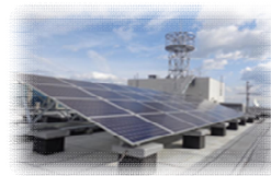
太陽光パネル
