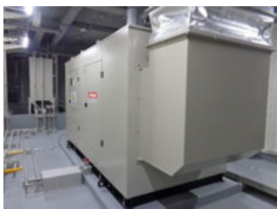
写真 5-5 自家発電設備 (徳島中央署)
