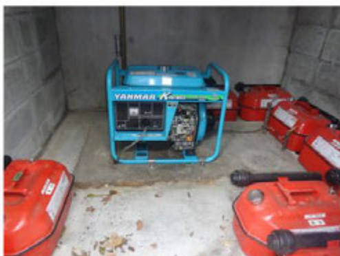
写真 2-10 自家発電装置(本館)
