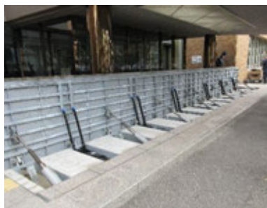
写真 5-4 止水板(徳島県警察本部)
