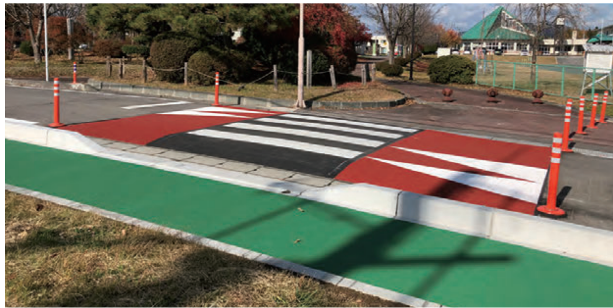
スムーズ横断歩道設置状況
